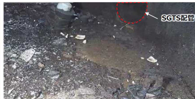
写真：SGTS配管状況（5/20雨天時）
