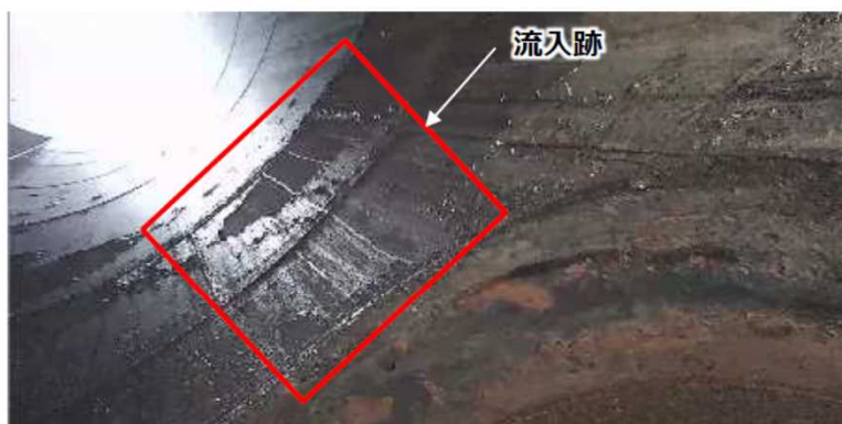
写真：排気筒内面状況（5/20雨天時）
