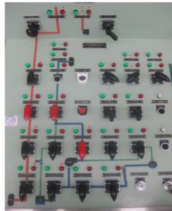
RCIC 制御盤 (後日撮影)
