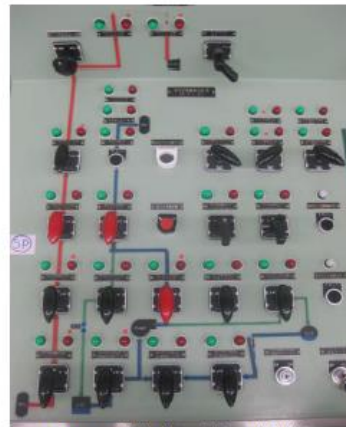
RCIC 制御盤 (後日撮影)
