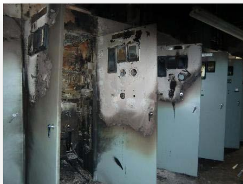
写真1 2011年3月11日 女川原子力発電所1号機
