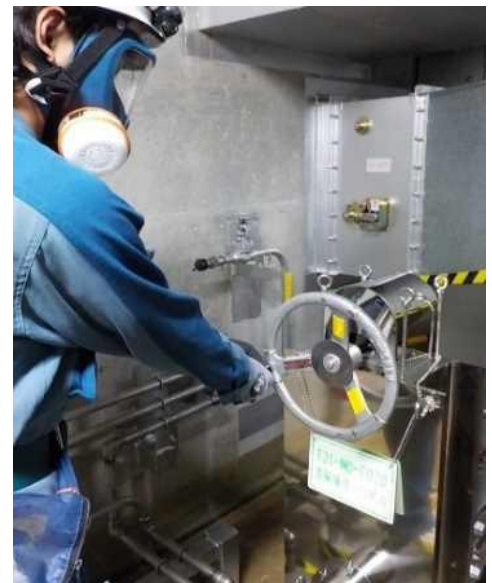
格納容器ベント操作
