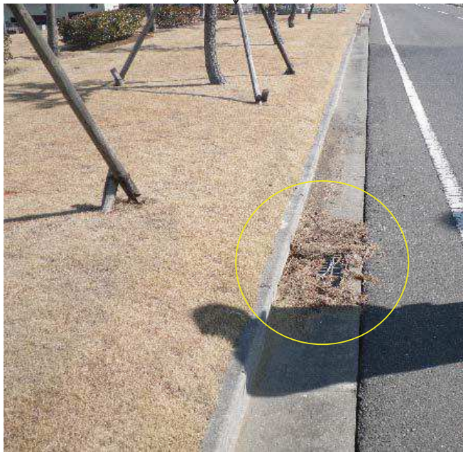
写真2 構内道路上に残留した塵芥
