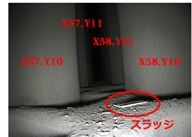
3号機 24回定期検査 スラッジ
