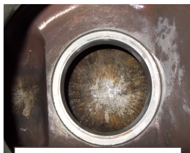
②水位制御弁内部
