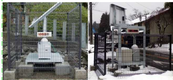
可搬型モニタリングポスト (福島県内 578台・福島隣県 130台)
