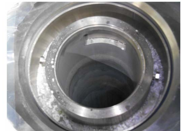
地下台車案内筒上部フランジのNa化合物付着状況
