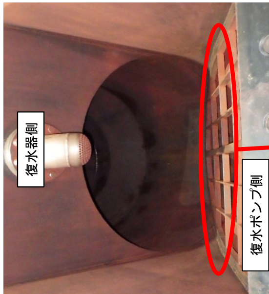
3B-復水ポンプ入口ストレーナ
