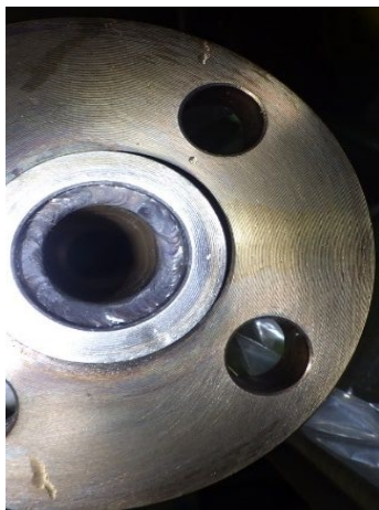
①入口配管
