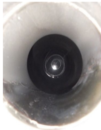
②出口配管
