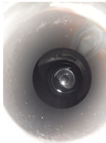
②出口配管
