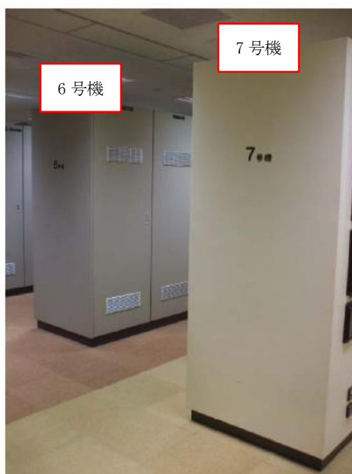
図2-26 制御盤（裏盤）の色別管理
