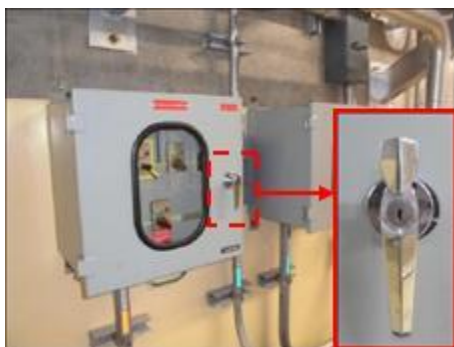
制御盤の施錠
