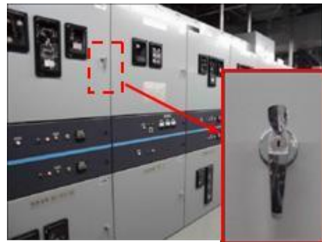
電源盤の施錠
