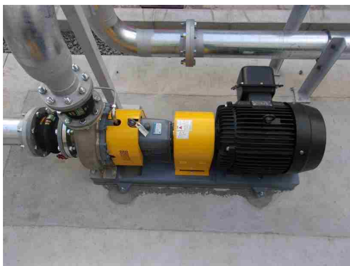
図 3.1.4.3-44 冷水循環ポンプ
