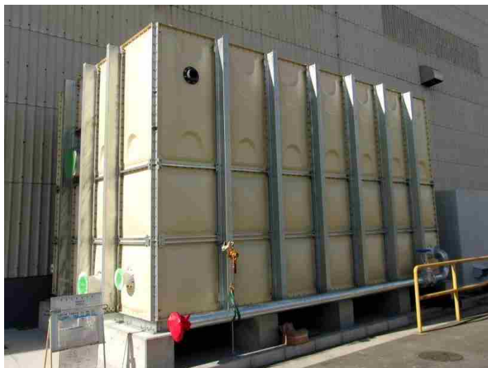
図 3.1.4.3-45 冷水貯留タンク
