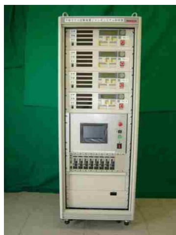
図 3.1.4.3-18 制御盤及び制御システム
