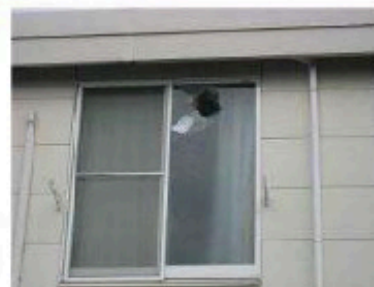
窓ガラスの飛来物衝突痕
