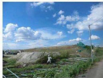
フェンスの倒壊
