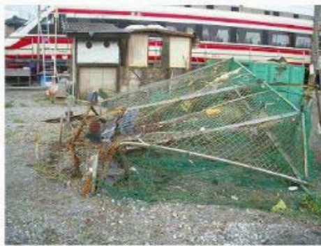
フェンスの著しい変形
