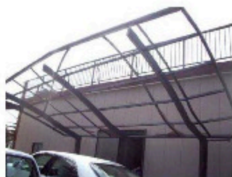
カーポート屋根の飛散及び骨組の損傷
