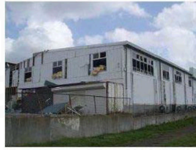
窓ガラスの損壊
