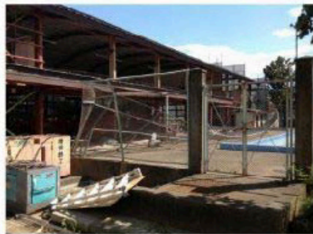
フェンスの変形（工事中の建築物）
