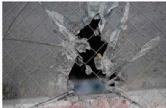
ガラスの被害状況（飛来物衝突痕）
