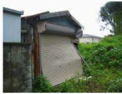
シャッターの外れ
