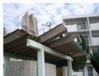
屋外トイレ屋根の損傷
