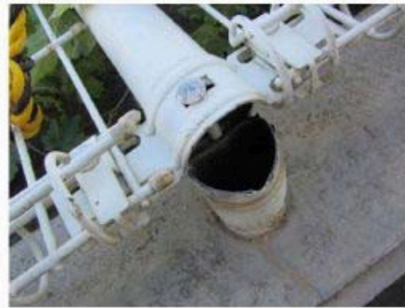
フェンス支柱部の破損
