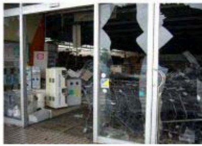
エントランスの窓ガラスの損壊
