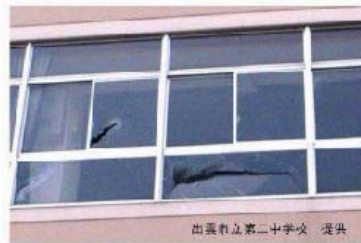
体育館窓ガラスの損壊
