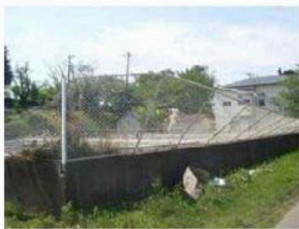
フェンスの変形
