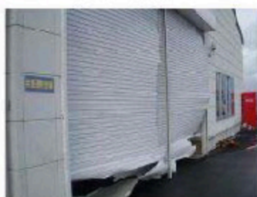
シャッターの変形
