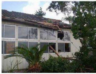
倉庫の窓ガラスと屋根の被害状況
