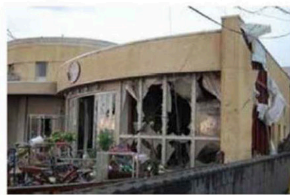
店舗の窓ガラスの被害状況
