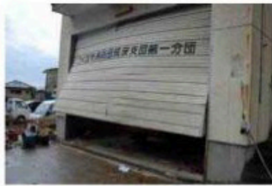
シャッターの変形
