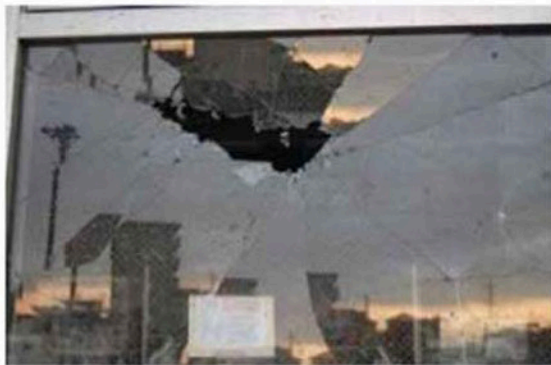
ガラスの被害状況（飛来物衝突痕）
