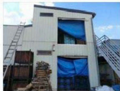
シャッターの外れ
