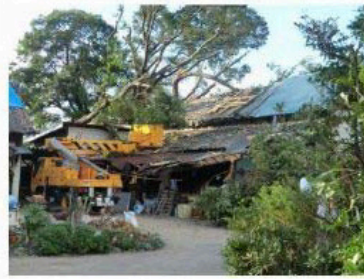
樹木の倒壊による小屋組の被害
