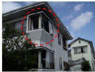
出窓部の窓ガラスの損壊
