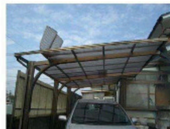
カーポート屋根の損傷
