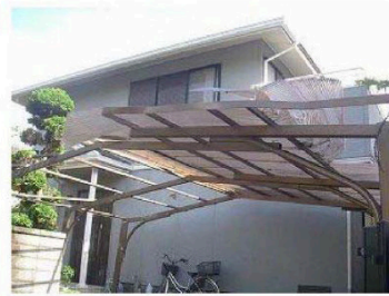
カーポートの被害
