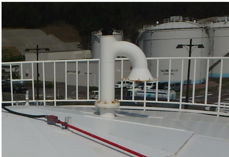
図 6-3 軽油タンクの通気口
