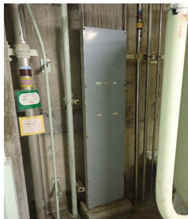
77. ケーブルダクト
