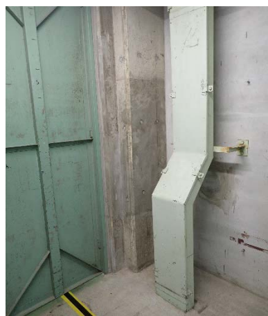
80. ケーブルダクト
