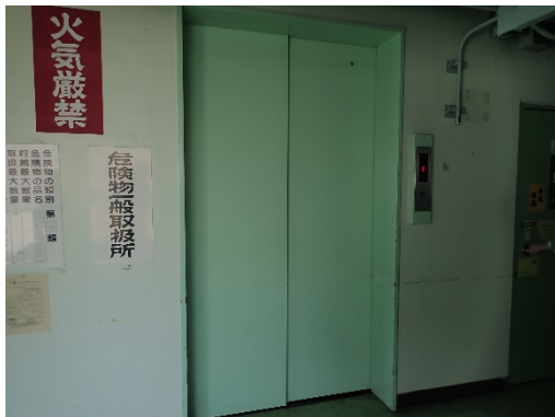
1. 荷物用エレベータ
