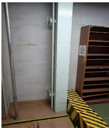
45. ケーブルダクト
