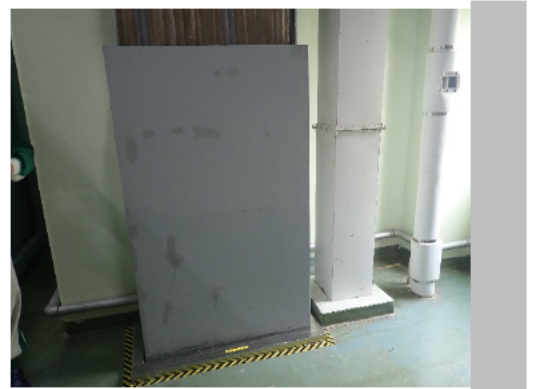
11. ケーブルダクト
