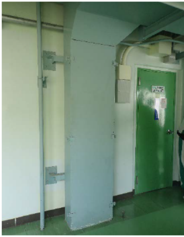
5. ケーブルダクト
