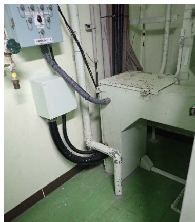
29. ケーブルダクト
