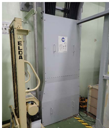
17. ケーブルダクト
