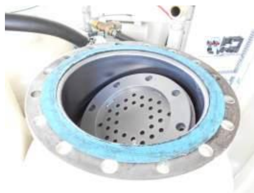
吸着槽1 上部分散板
