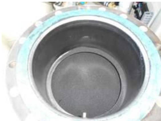
事象発生時の当該活性炭充填状況
