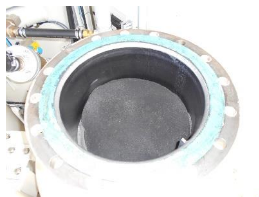
吸着槽1 上部スポンジ
