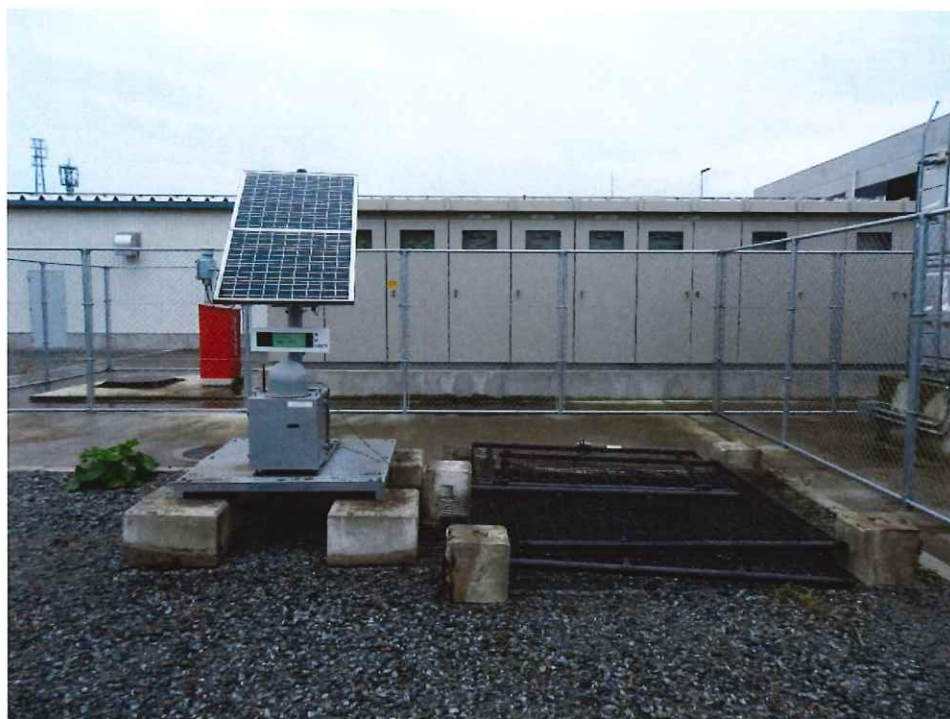
図 2-9-2-9(3) 保管中のモニタリングポスト (福島県環境創造センター 環境放射線センター (南相馬市)) : 平成 29 年 9 月 7 日撮影)
