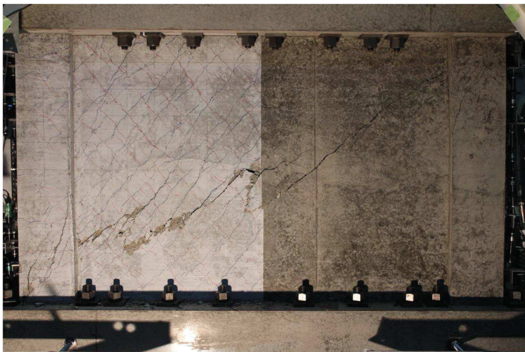
図 3-7 試験体 S-13-D I 最終破壊時写真
