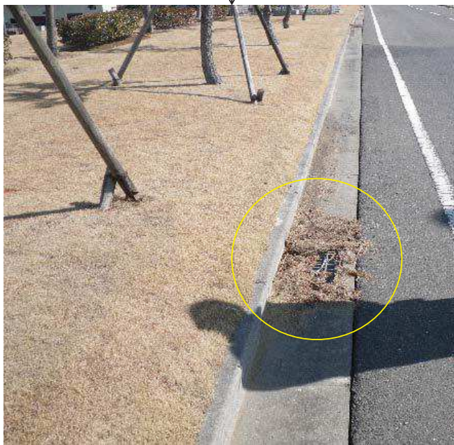
写真2 構内道路上に残留した塵芥
