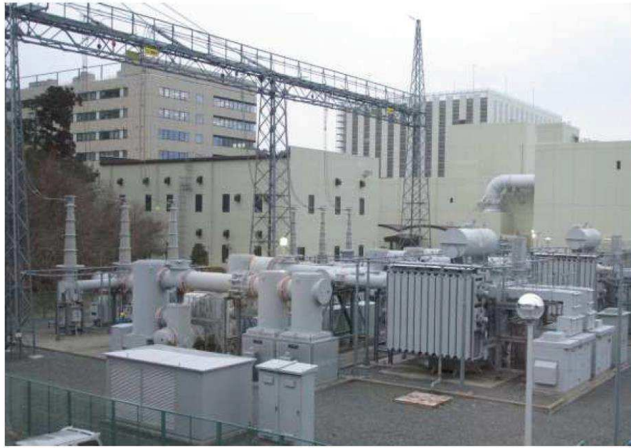
図 3-16 275kV 開閉所の外観
