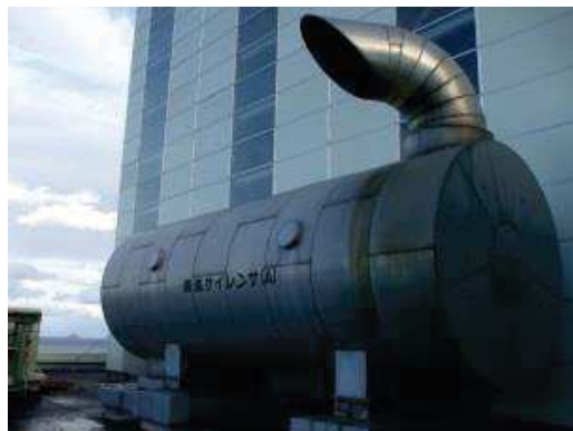
図 1.5-8 非常用ディーゼル発電設備排気消音器
