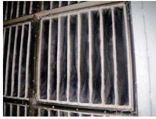
(バグフィルタ入口側)
