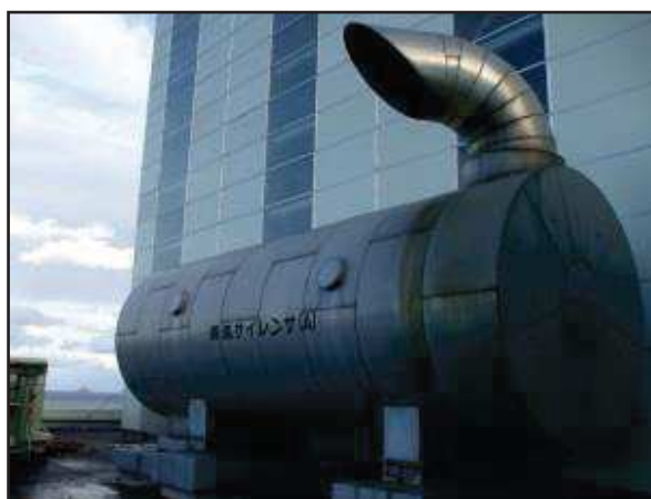
図 2.3-8 ディーゼル発電機 排気管
