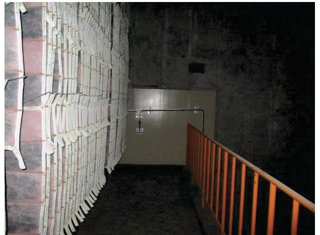
(バグフィルタ出口側)
