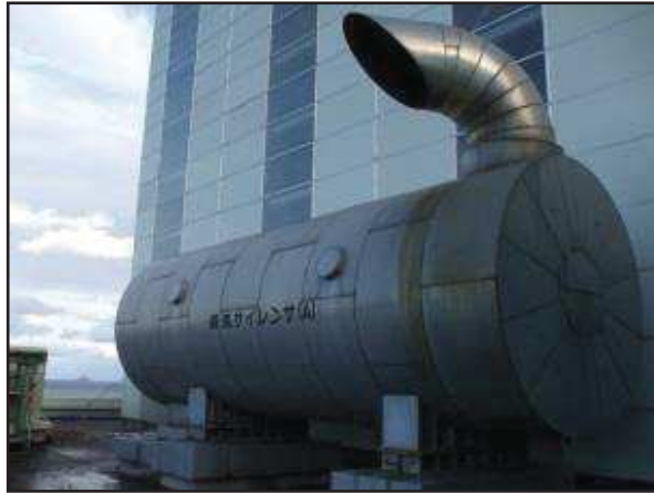
図1 ディーゼル発電機 排気管
