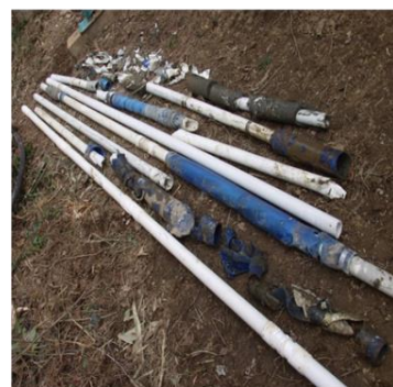
回収されたMP観測装置(59.5-114.4M) MPケーシング、レギュラーカップリング、ロケーションカラー、メジャメントカップリング、ポンピングポーT、パッカー
