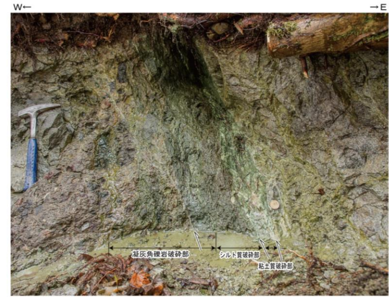
同左拡大 破砕部は幅45cm程度で、凝灰角礫岩破砕部、シルト質鱗片状破砕部及び粘土質破砕部からなり、軟質である。
