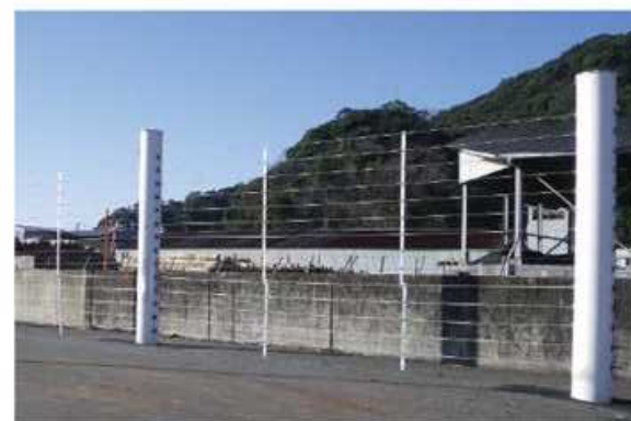
津波漂流物捕捉施設
