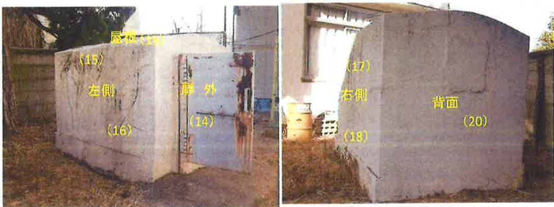
貯蔵・廃棄施設
