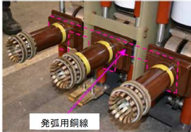
発弧線の設置状況(遮断器2次側端子)
