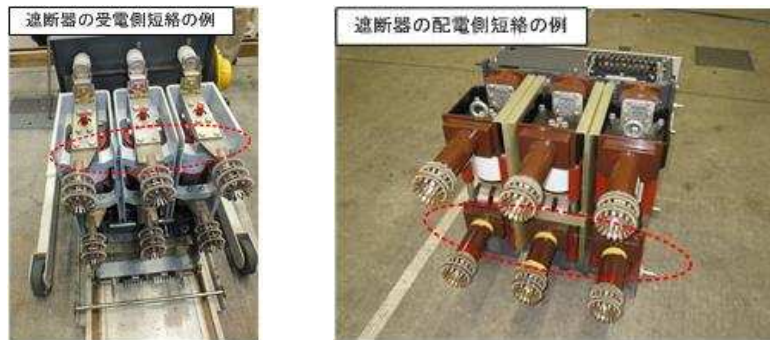
図 4-7 遮断器の短絡箇所 (M/C 試験時)
