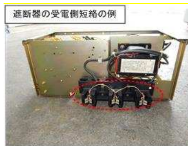
図 4-9 遮断器の短絡箇所 (MCC 試験時)
