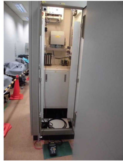
<可搬型計測器接続>
