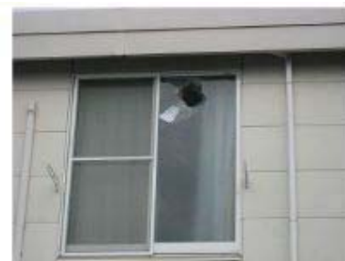
窓ガラスの飛来物衝突痕
