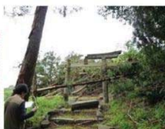
樹木の折損と鳥居の被害
