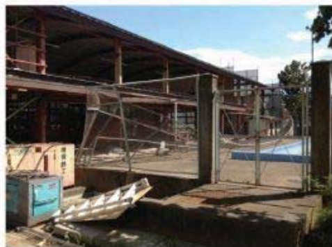
フェンスの変形（工事中の建築物）
