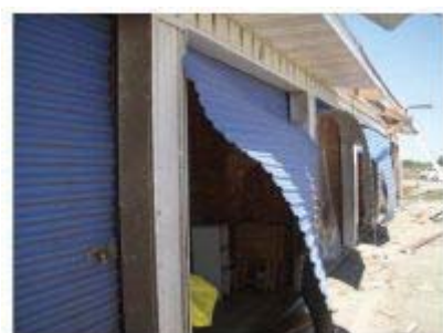
シャッターの外れ
