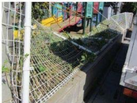
フェンスの変形
