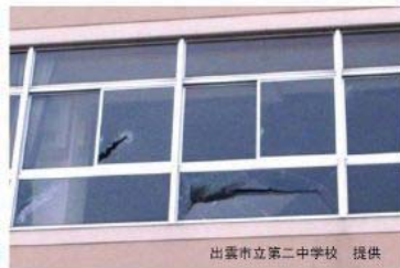
体育館窓ガラスの損壊
