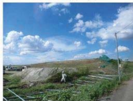
フェンスの倒壊
