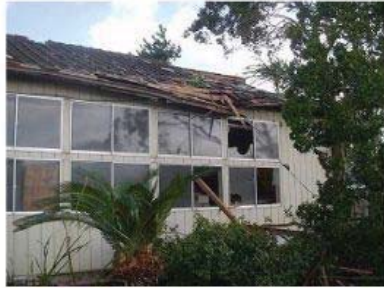
倉庫の窓ガラスと屋根の被害状況
