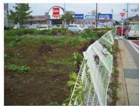
フェンスの変形
