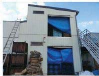
シャッターの外れ
