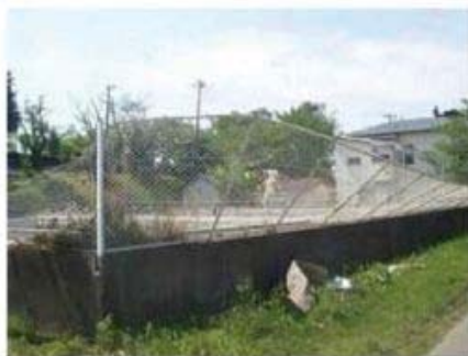
フェンスの変形
