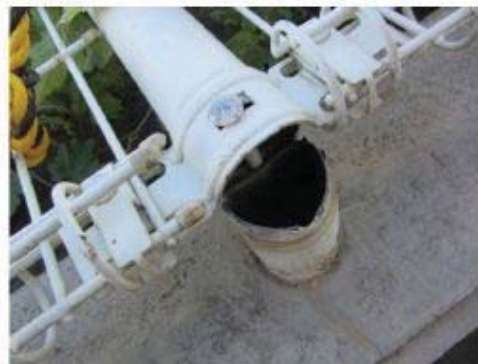
フェンス支柱部の破損
