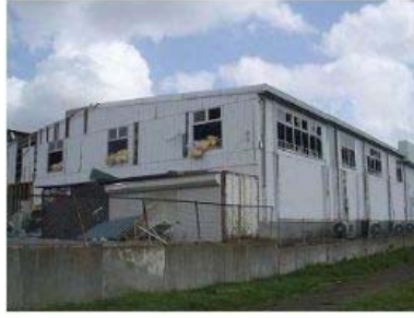
窓ガラスの損壊
