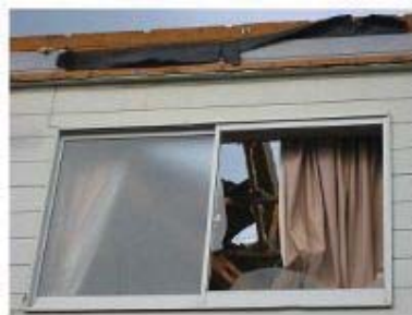
窓ガラスの損壊
