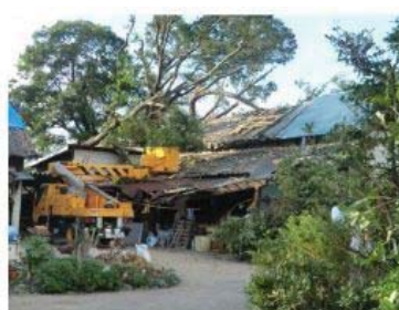
樹木の倒壊による小屋組の被害
