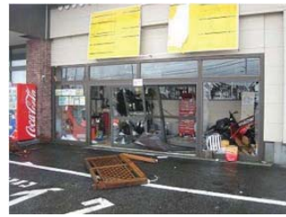
エントランスのガラス損壊
