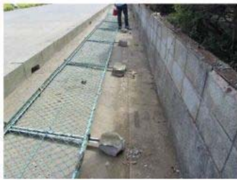
フェンスの倒壊
