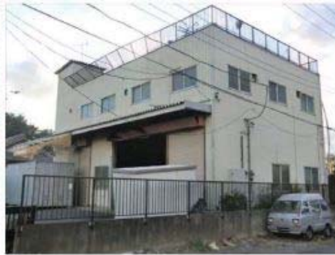
屋上フェンスの変形
