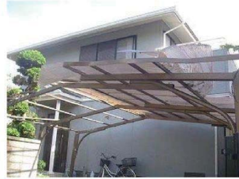
カーポートの被害
