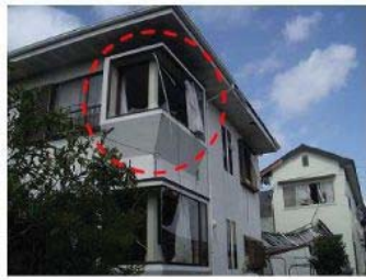
出窓部の窓ガラスの損壊
