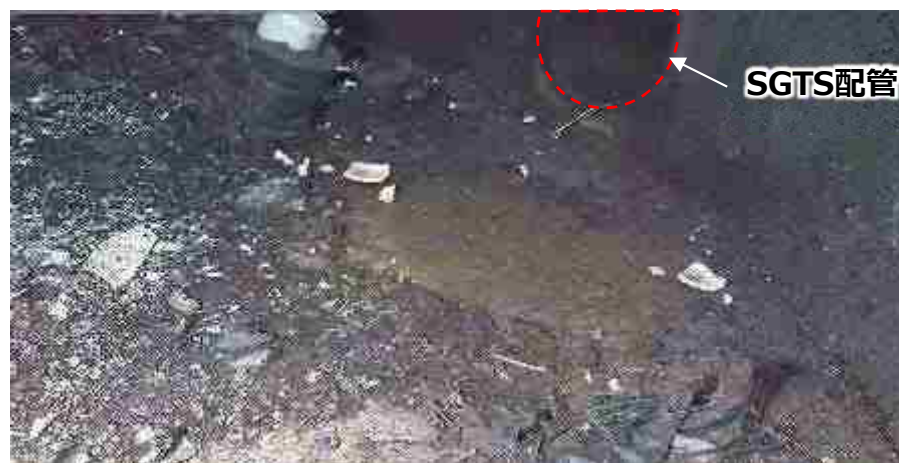
写真：SGTS配管状況（5/20雨天時）
