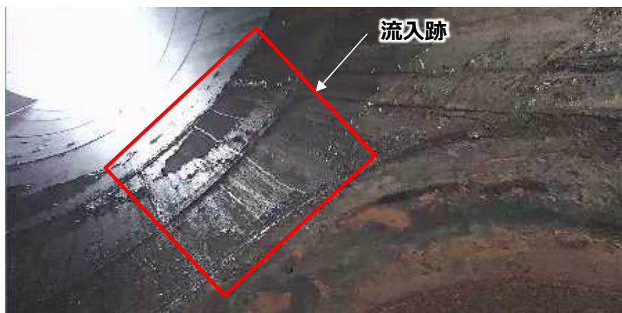
写真：排気筒内面状況（5/20雨天時）
