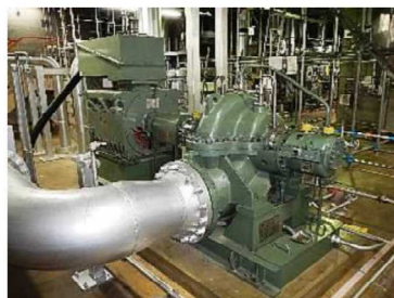
ポンプ、配管、支持構造物の例
