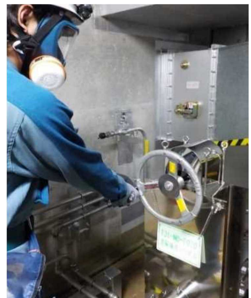
格納容器ベント操作
