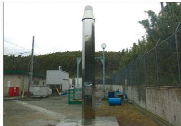
竹島の機器設置状況
