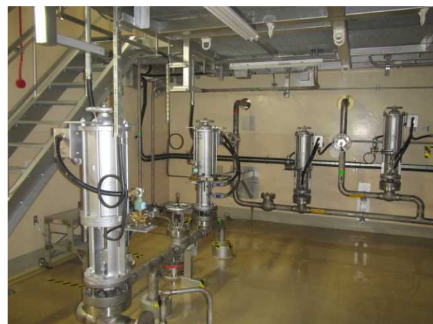
HCW バルブ室の可燃物の状況（可燃物なし）
