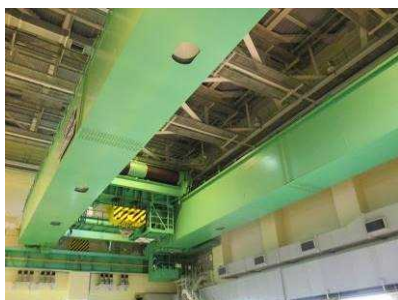
原子炉建屋クレーン
