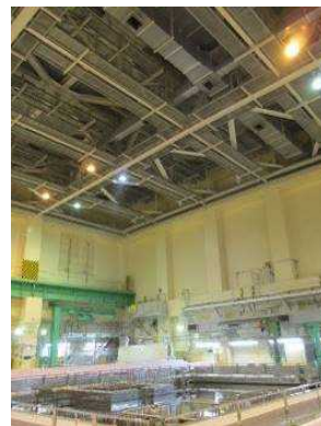
使用済燃料貯蔵プール 上部天井
