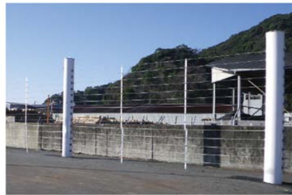
津波漂流物捕捉施設
