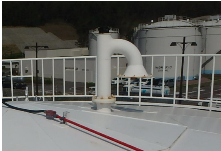
図 6-3 軽油タンクの通気口
