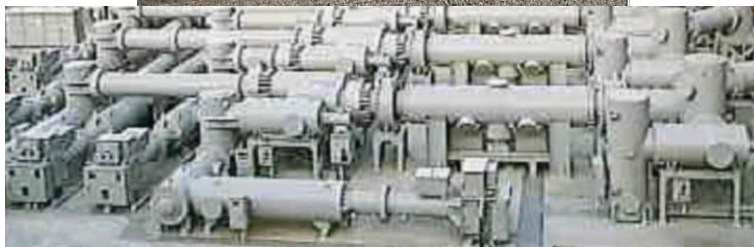
気中架線設備[3]
