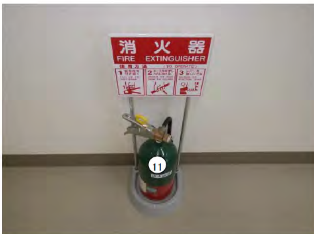
消火器 (α線測定室) No. 11
