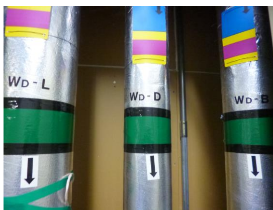
写真 2. 漏えいが確認された D 排水系統 排水管 (中央)
