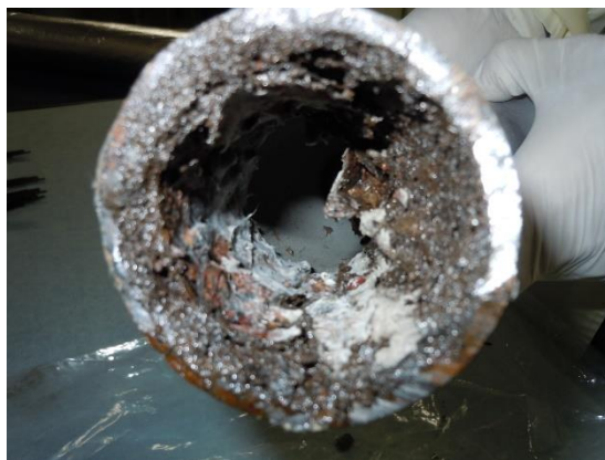
断面写真 2. 横引き配管の切断部位
