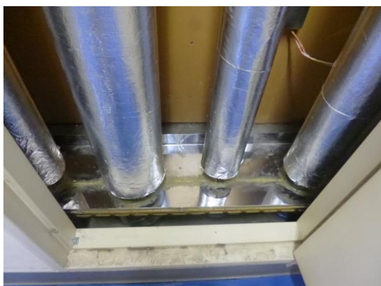
写真 3. 漏えい水が溜まっていたパイプシャフト内の受け皿 (D 排水系統は右から 2 番目)
