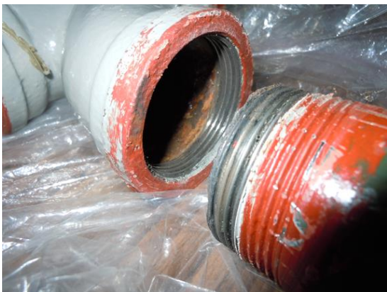
写真 13. ④部分_排水管の継手との接続部
