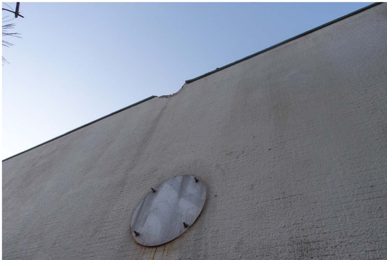
添付資料 6 研究棟屋根表面の損傷部分
