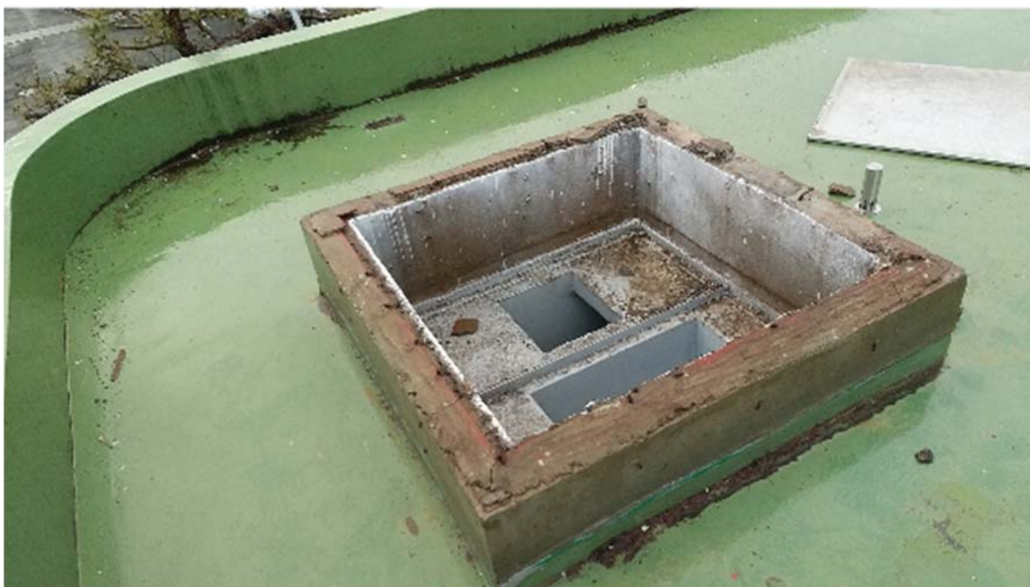
排気筒倒壊直後の開口部
