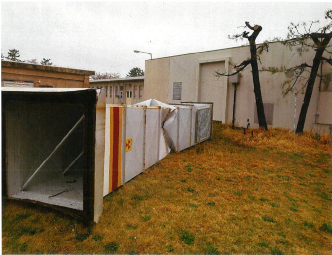
排気筒 倒壊写真
