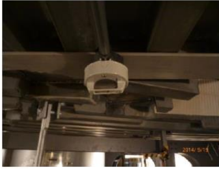
原子炉格納容器内熱感知器
