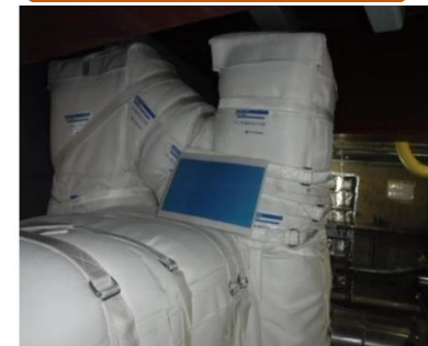
原子力発電所の対策例 (耐火ラッピング材施工イメージ)
