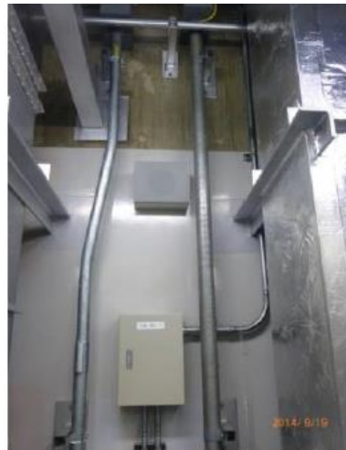
電線管による対策例 (安全保護系ケーブル)
