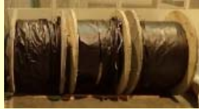
安全系負荷への 予備ケーブルの配備
