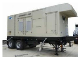
移動式発電機
