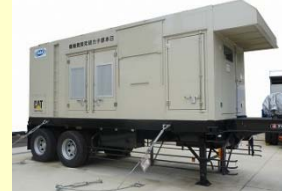
移動式発電機 (1000kVA)
