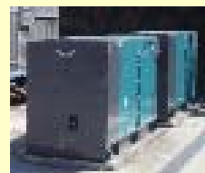
可搬型発電機 (550kVA)
