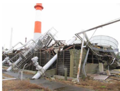
二次冷却塔倒壊時の状況
