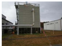
UCL系統冷却塔の固定の状況
