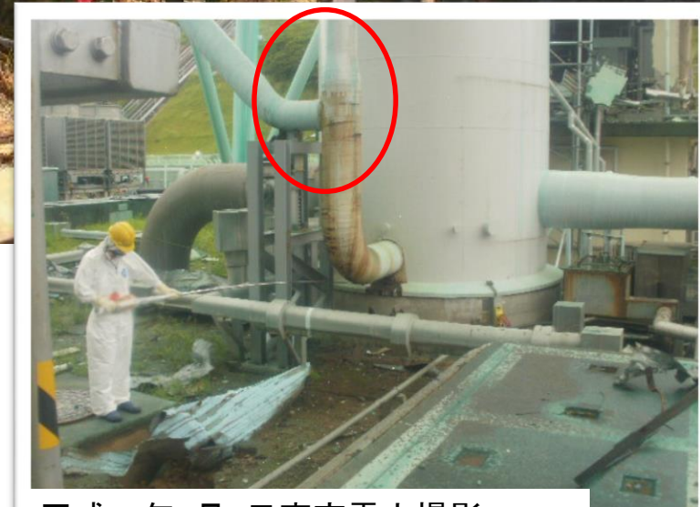
平成23年8月1日東京電力撮影
