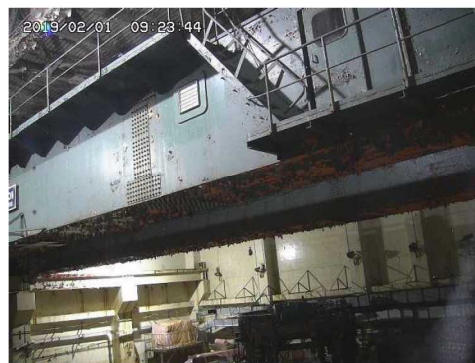
【天井クレーン】
