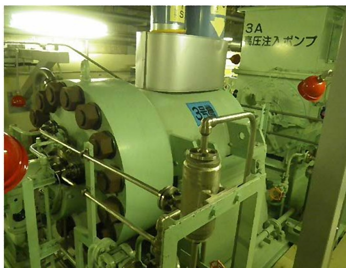
図 36-2 3A,3B 高圧注入ポンプ 外観
