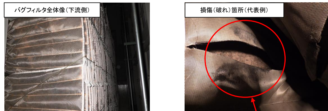
図1 バグフィルタ損傷状況写真(代表例:浜岡5号機原子炉室排気バグフィルタ(A))
